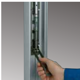
Spennfestet skyves opp slik at topp-platen får kontakt med taket innen staven settes fast ordentlig.
